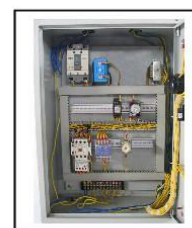
ลักษณะภายในตู้ควบคุมเครื่องสูบน้ำแบบหอยโข่ง
