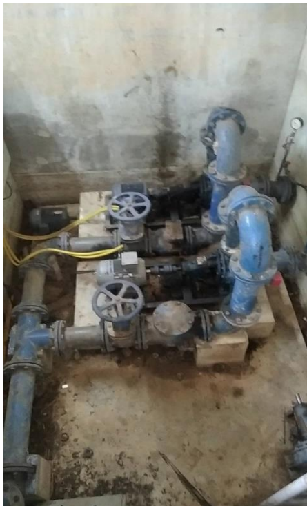
รูปที่ 1. เครื่องสูบน้ำดิบติดตั้งในโรงสูบน้ำ
