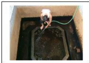
รูปที่ 49 การใช้น้ำฉีดล้างหน้าทรายกรอง
