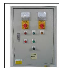
ลักษณะภายนอกตู้ควบคุมเครื่องสูบน้ำแบบหอยโข่ง
