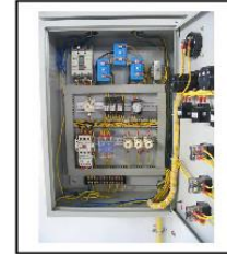
ลักษณะภายในตู้ควบคุม เครื่องสูบน้ำแบบหอยโข่ง
