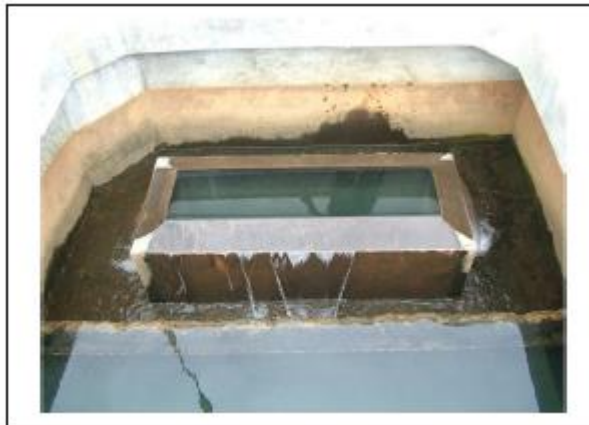
รูปที่ 23 รางรับน้ำลงถังกรองทราย
