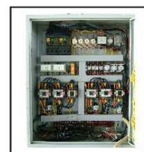
ลักษณะภายในตู้ควบคุม เครื่องสูบน้ำแบบหอยโข่ง
