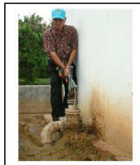
รูปที่ 62 เปิดประตูน้ำระบายตะกอน ข้างถังรวมตะกอน ( ประตูน้ำหมายเลข 8)
